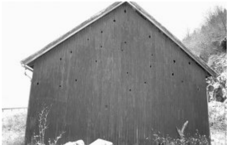
På denne låveveggen har spetthullene kommet til over en årrekke. Hullenes størrelse indikerer at flaggspett og gråspett er høyaktuelle gjerningsarter. Bildet er tatt mellom Orkanger og Geitastrand i Orkdal i Sør-Trøndelag i november 2002. (Foto: Frengen)
